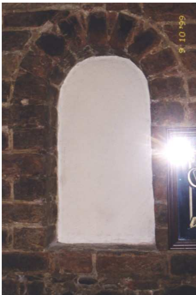
Ryc. 251. Blenda okienna w piwnicy kamienicy przy ul. Wieżowej 2. Fot. M. Kucharski
