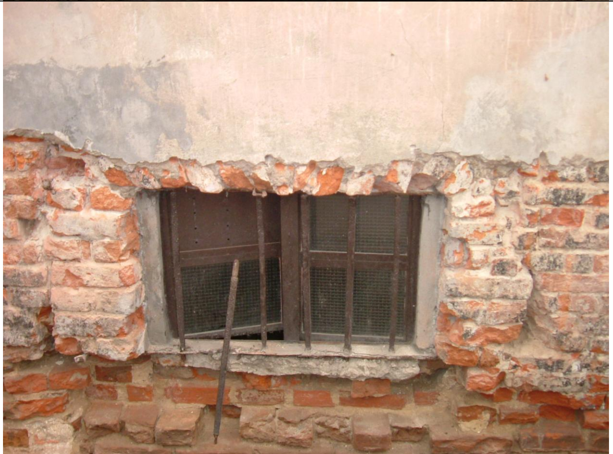
Skucia tynków poświadczają że parapety są w piwnicy. Budynek ma podobną konstrukcję
