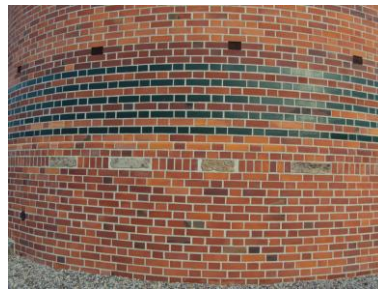
Ryc. 79. Wyeksponowanie czterech bloczków z dawnego cokołu. Stan w grudniu 2014 r. Fot. M. Szajerka
