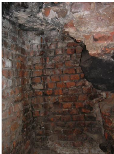
Ryc. 41. Wnętrze klatki schodowej w murze ściany południowej, skrzydła południowego, prowadzącej na piętro do Sali Herbowej, dawniej refektarza. Stan z 15.07.2008 r. Fot. M. Szajerka.
