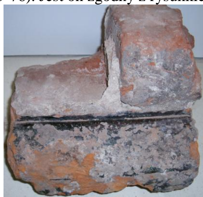
Fot. 75. Fragment cokołu z wieży Klimek. Stan z 12.12. 2006 r. Fot. M. Szajerka.
