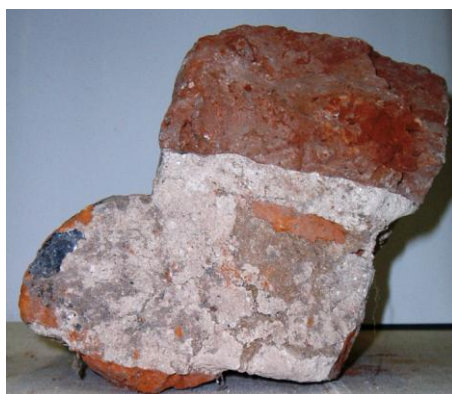
Fot. 76. Fragment cokołu z wieży Klimek, przekrój. Stan z 12.12. 2006 r. Fot. M. Szajerka.
