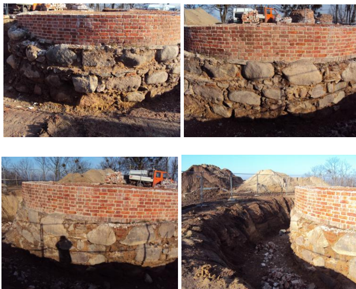
Ryc.68-71. Fundament wieży Klimek. Stan z 14.02.2014 r., przed wykonaniem betonowego pierścienia, wzmacniającego fundament w związku z odbudową wieży Klimek. Fot. M.Szajerka.
