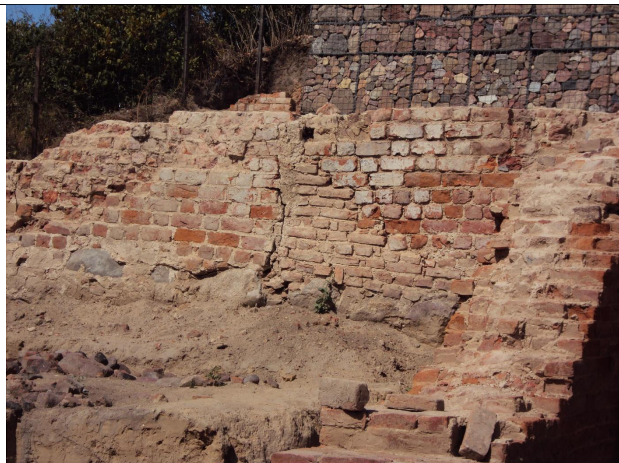
Ślad po naprawie, w następstwie katastrofy budowlanej. Zdjęcie z sierpnia 2014 r. W murze jednocześnie występują cegły romańskie i gotyckie.
