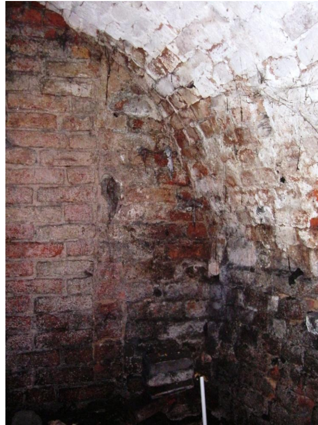
Zamurowana na pół cegły szczelina. Widoczny hak okapu szczeliny.
